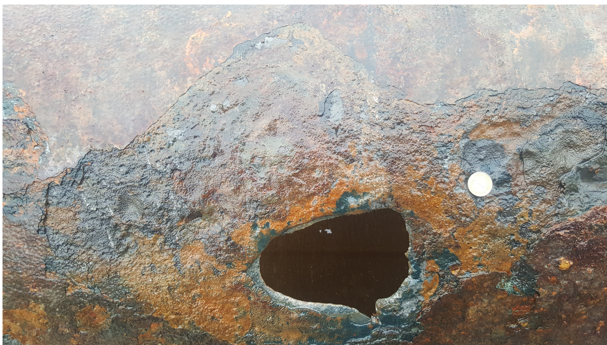
Rysunek 16: Fragment rury wodociągowej z ubytkami spowodowanymi prądami błędzącymi.
