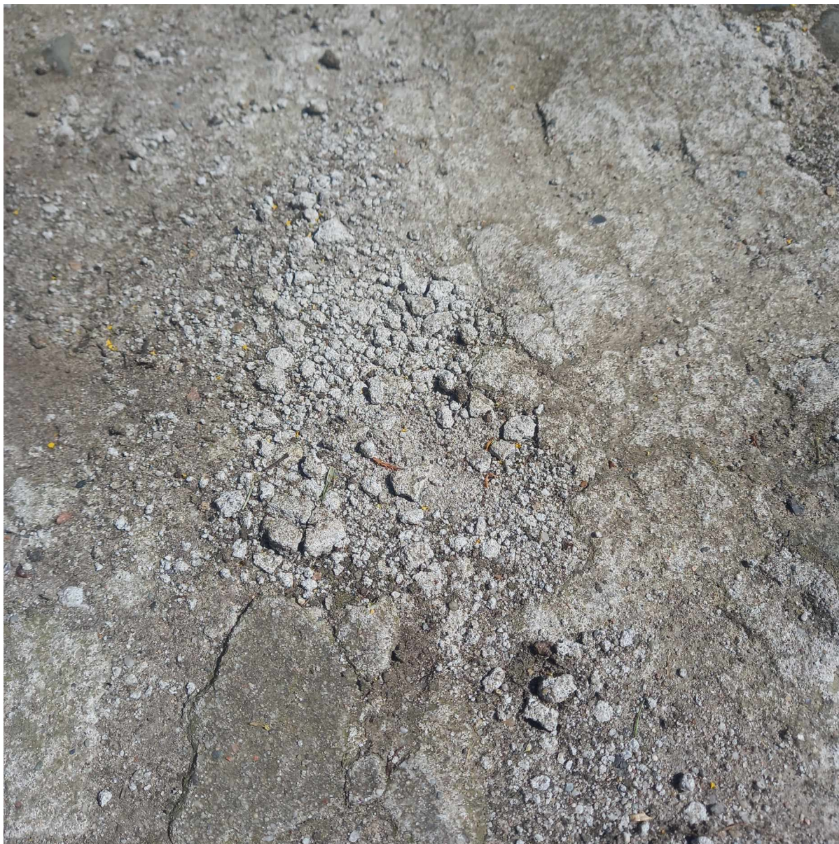
Rysunek 27: Korozja betonu.
