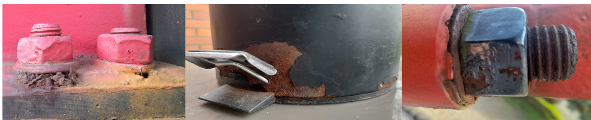
Rysunek 33: Przykłady korozji lokalnej.
