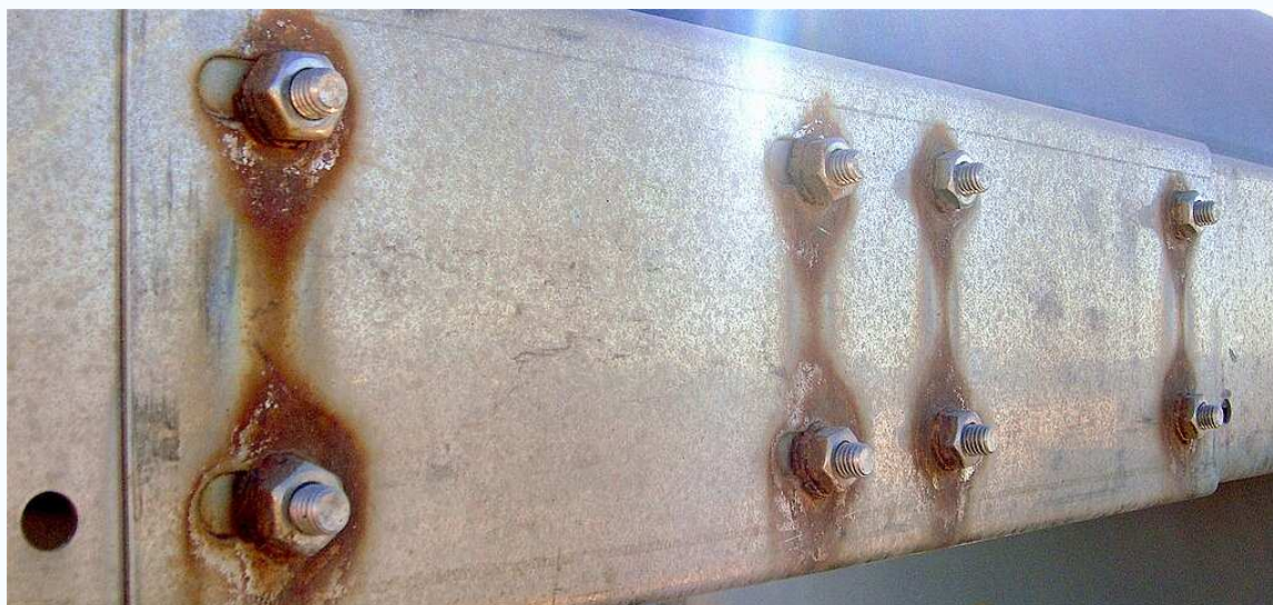
Rysunek 18: Korozja atmosferyczna i galwaniczna. Fot. D3j4vu, Stainless-steel-mild-steel.jpg, licencja CC BY-SA 3.0, źródło: Wikimedia Commons .
