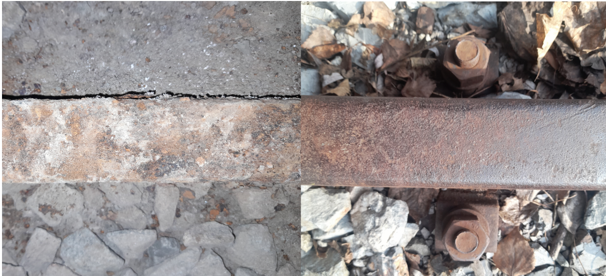
Rysunek 31: Korozja ogólna szyny kolejowej w różnych środowiskach.
