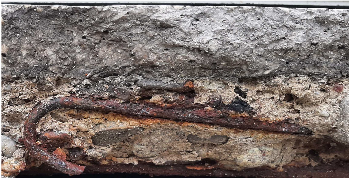
Rysunek 20: Korozja drutu zbrojeniowego w betonie.
