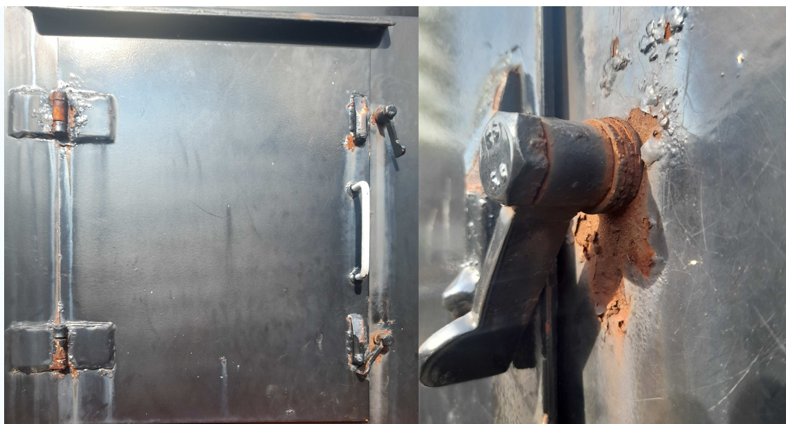
Rysunek 45: Przykład korozji szczelinowej zawiasów i podkładek (po lewej), powiększenie skorodowanej zasuwy (po prawej).
